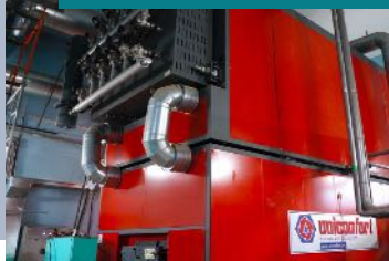
Котельная на биомассе Крупки
