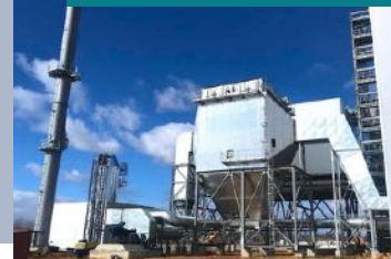
Электростанция на биомассе Быхов
