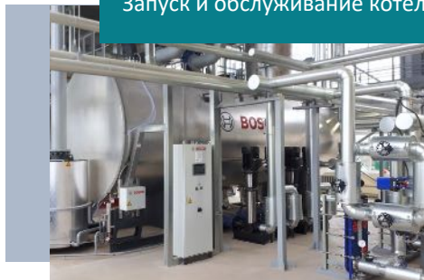
Запуск и обслуживание котельных
