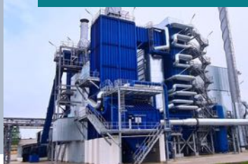
Энергоцентр на биомассе Пинск
