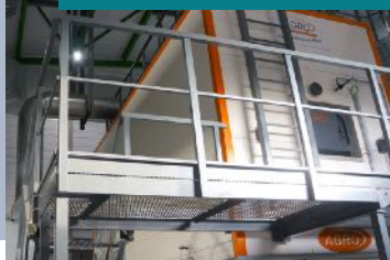
Котельная на биомассе Полоцк
